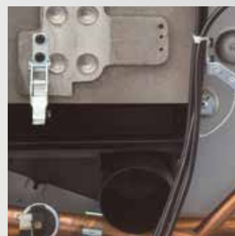
A kondenzvíz gyűjtő kioldása
